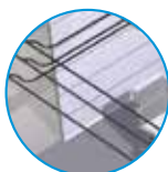
3-csöves hűtőközeg csőrendszer
